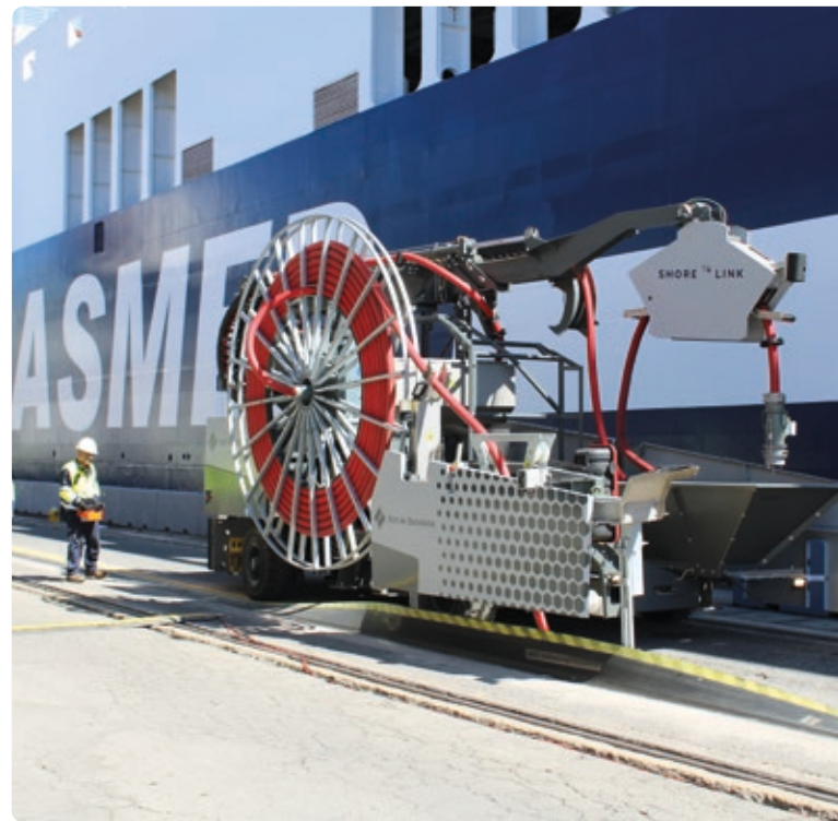
► Dentro de las iniciativas puestas en marcha en los puertos españoles destaca el proyecto OPS (Onshore Power Supply).
