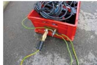
Caja de puesta a tierra
