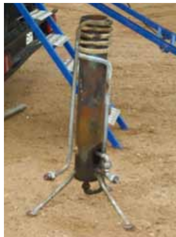
Antorcha para combustión de gases de venteo
