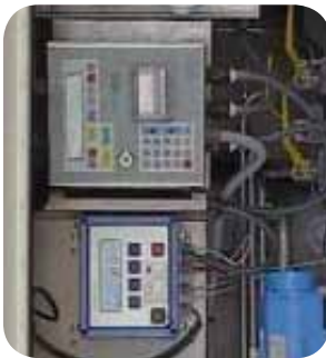
CONTROL DE LA BOMBA
