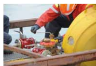
Apertura de válvula fase gaseosa
