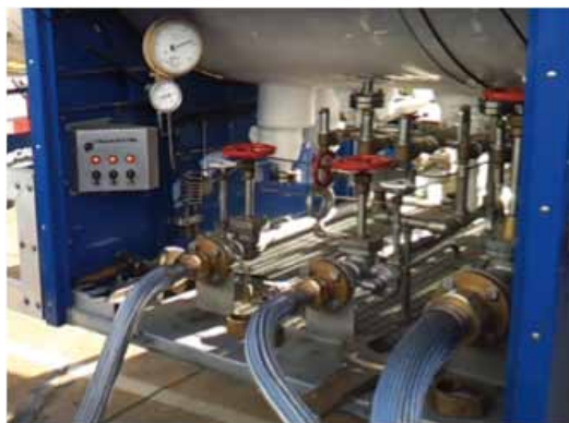
Fig. 18. Conducciones fase líquida y gas para trasvasar con un PPR portátil. (Foto cortesía de ESK)
