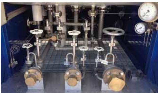
Cisterna de GNL. Las válvulas de sobrepresión del depósito son las rotuladas como PSV1
