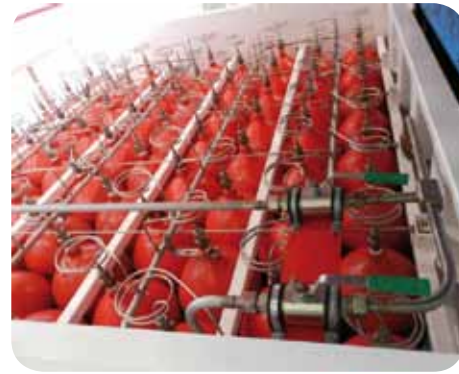
VÁLVULAS DE MÓDULOS
